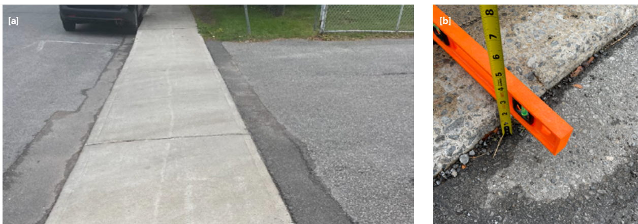
FIGURE 1 | ILLUSTRATION DU BATEAU-PAVÉ À LA BIBLIOTHÈQUE DE SAINT-MICHEL DANS L'ARRONDISSEMENT DE VILLERAY-SAINT-MICHEL-PARC-EXTENSION COMPARATIVEMENT À UN BATEAU-PAVÉ SUFFISAMMENT ABAISSÉ AU CHALET DU PARC DALBÉ-VIAU DANS L'ARRONDISSEMENT DE LACHINE
